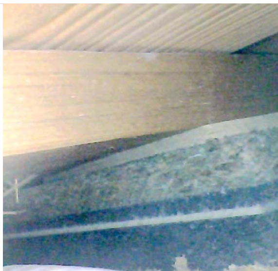
Niewłaściwy sposób poziomowania legara górnego, oraz podłogi.
