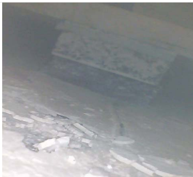
Niewłaściwy sposób poziomowania legara górnego, oraz podłogi.
