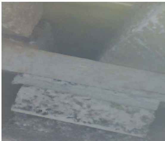
Niewłaściwy sposób poziomowania legara górnego, oraz podłogi.
