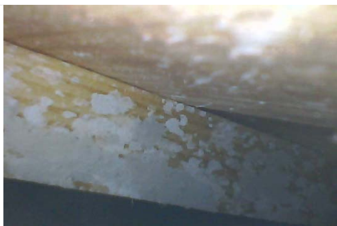
Brak estetyki w montażu elementów zakrytych. Legar górny powierzchnia boczna zanieczyszczona bliżej nieokreślonym materiałem
