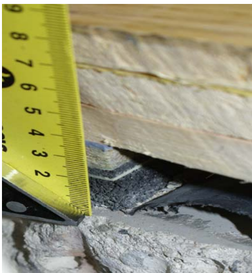
Niewłaściwy sposób poziomowania legara górnego, oraz podłogi.
