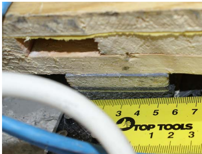
Niewłaściwy sposób poziomowania legara górnego, oraz podłogi.
