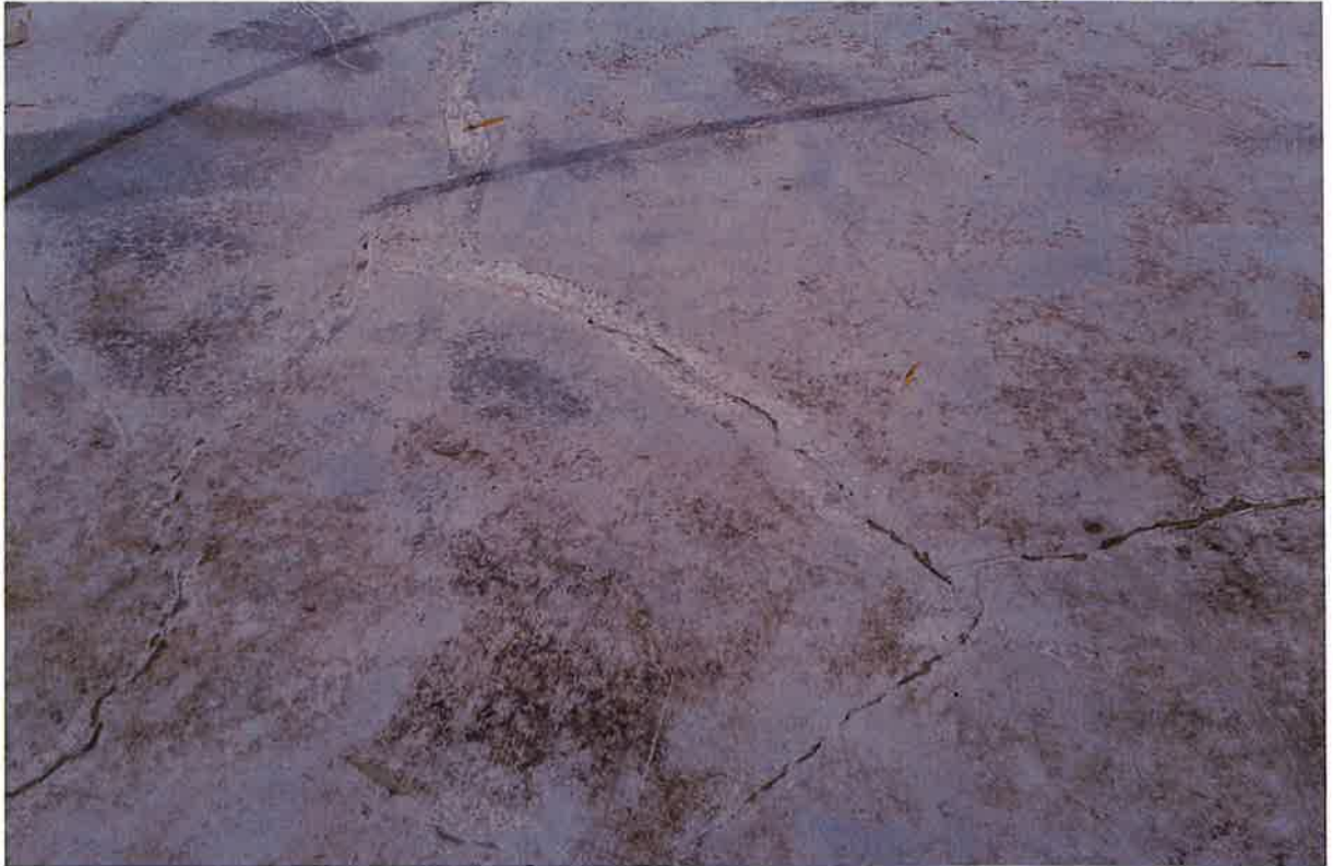
Zarysowanie płyty dennej z widocznym miejscowym uszczelnieniem masami naprawczymi.
