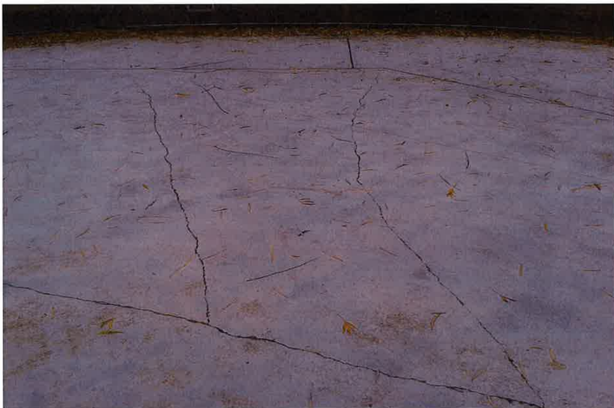
Zarysowanie płyty dennej w strefie przeznaczonej pod montaż płyty lodowiska zewnętrznego oraz planowanych pomieszczeń obsługi.
