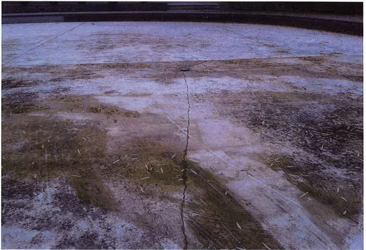
Zarysowanie płyty dennej w strefie zaplecza lodowiska.
