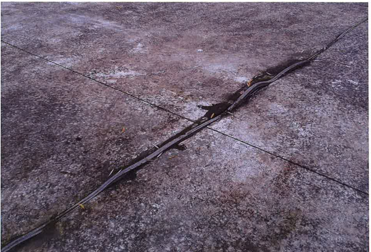
Miejscowa deformacja taśmy dylatacyjnej w płycie dennej przy przejściu przez dylatację szczelinową.
