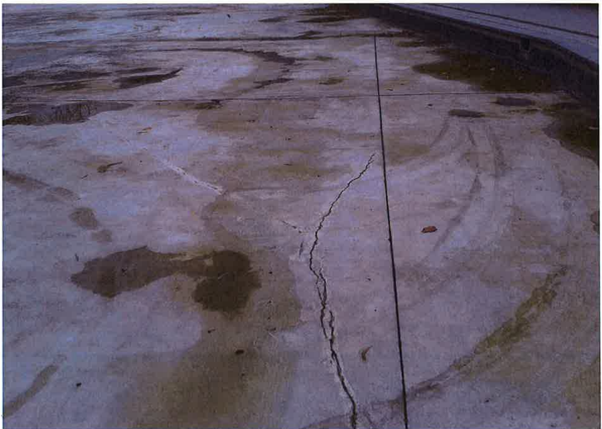
Zarysowanie płyty dennej w sąsiedztwie skrzyżowania dylatacji.
