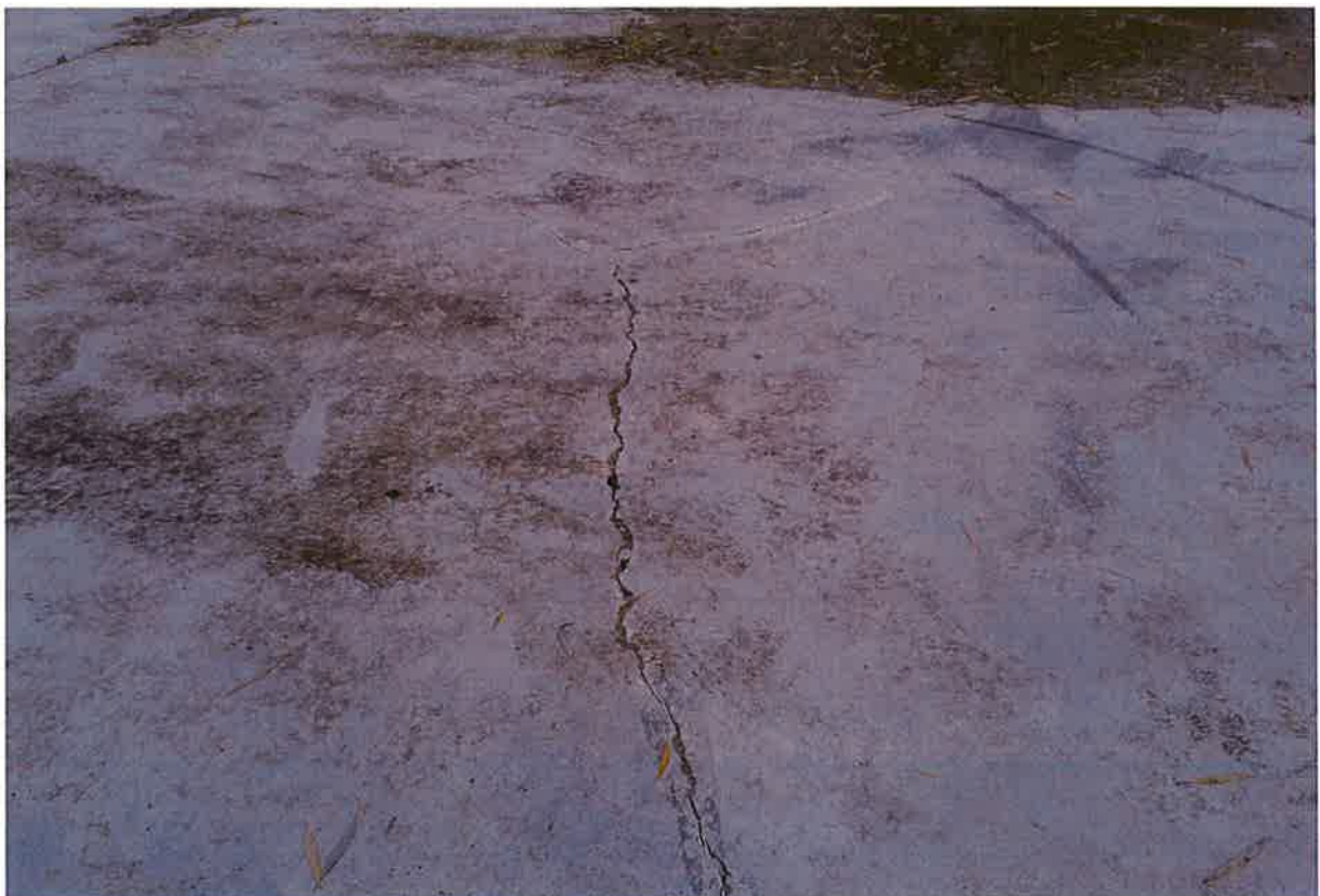
Zarysowanie płyty dennej w strefie planowanej dla posadowienia zaplecza lodowiska.
