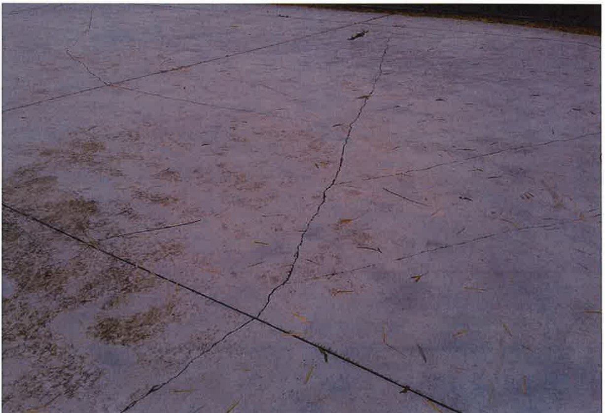
Zarysowanie płyty dennej w strefie przeznaczonej pod montaż płyty lodowiska zewnętrznego.
