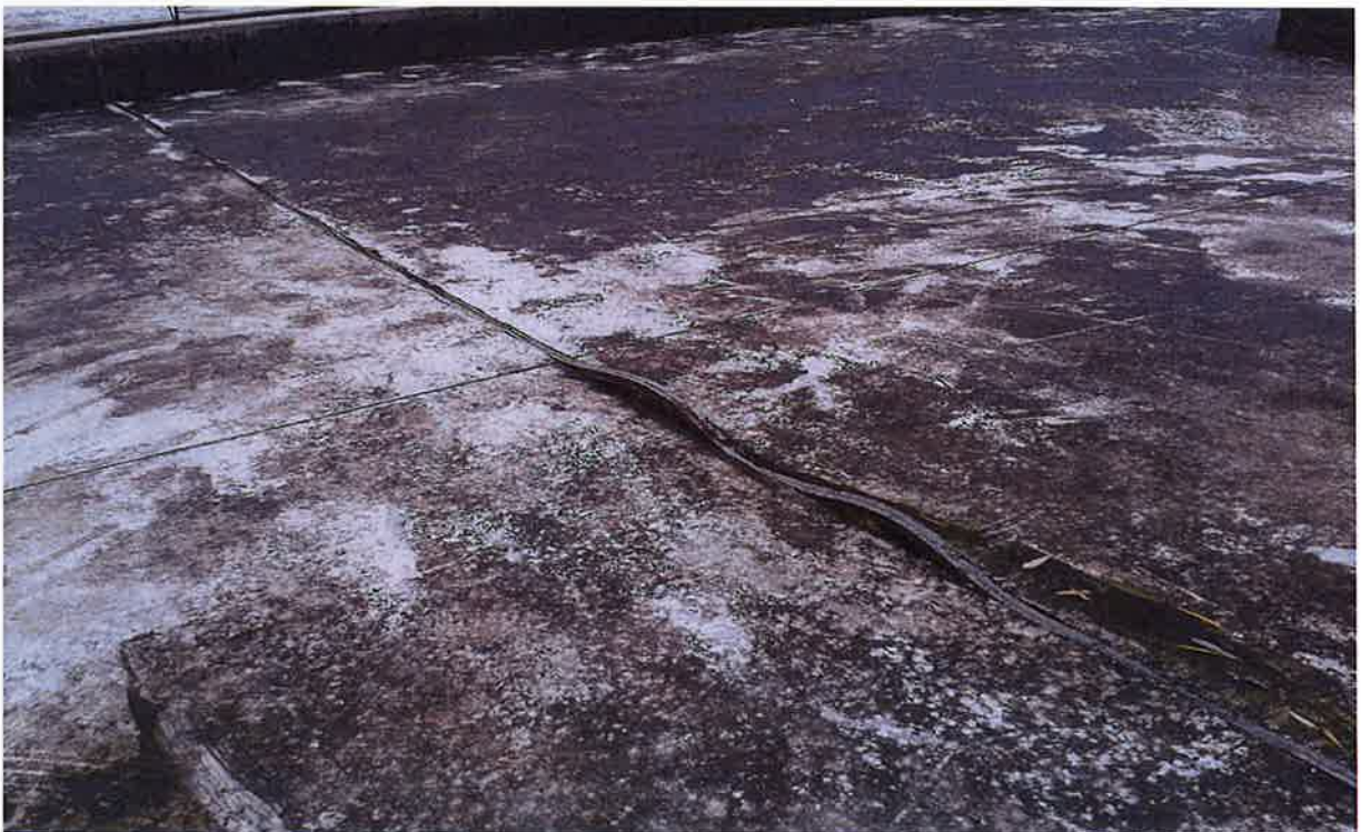
Miejscowa deformacja taśmy dylatacyjnej w płycie dennej w sąsiedztwie fontanny łukowej.
