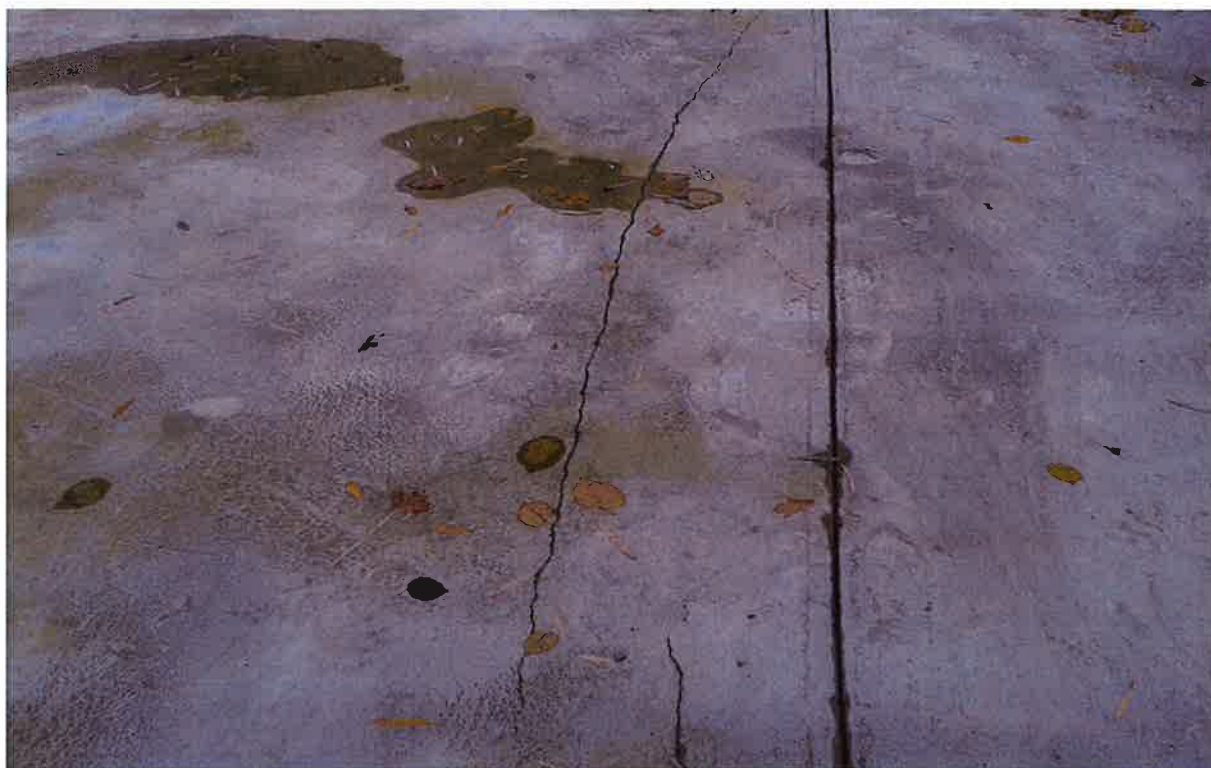
Zarysowanie płyty dennej w sąsiedztwie dylatacji.
