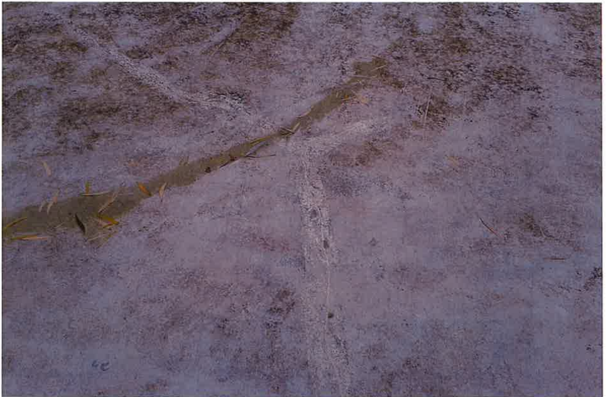
Zarysowanie płyty dennej z widocznym miejscowym uszczelnieniem masami naprawczymi.
