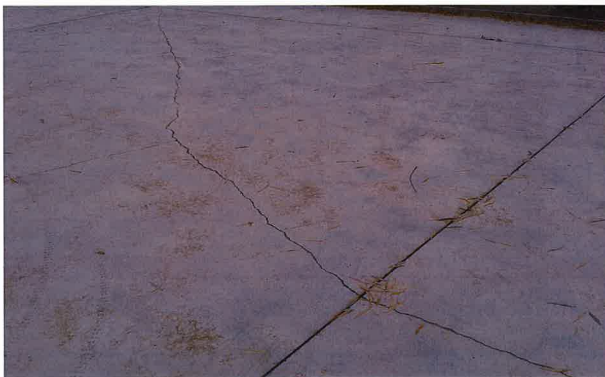
Zarysowanie płyty dennej w strefie przeznaczonej pod montaż płyty lodowiska zewnętrznego oraz strefy wejścia na taflę.
